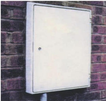
(D) BUILT-IN METER BOX
