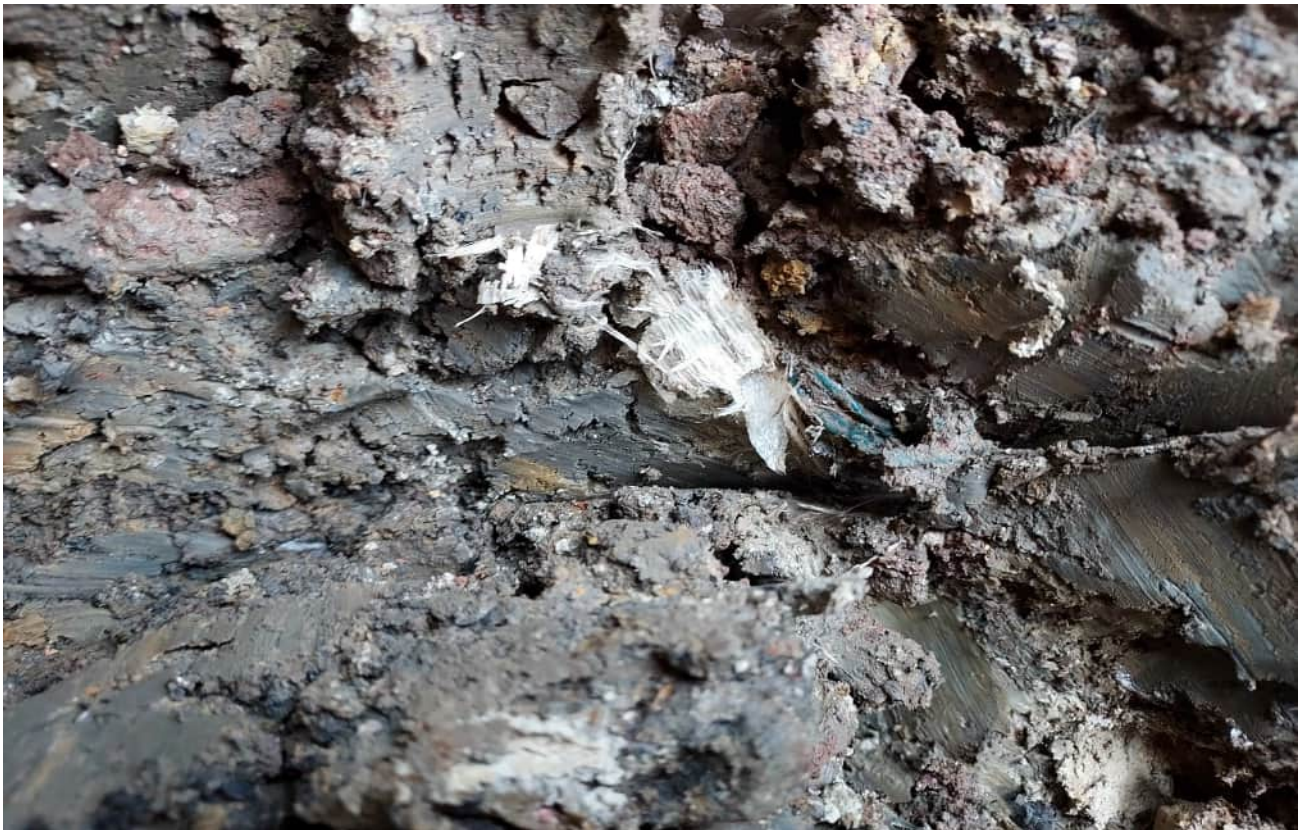
HDP105 Possible asbestos
