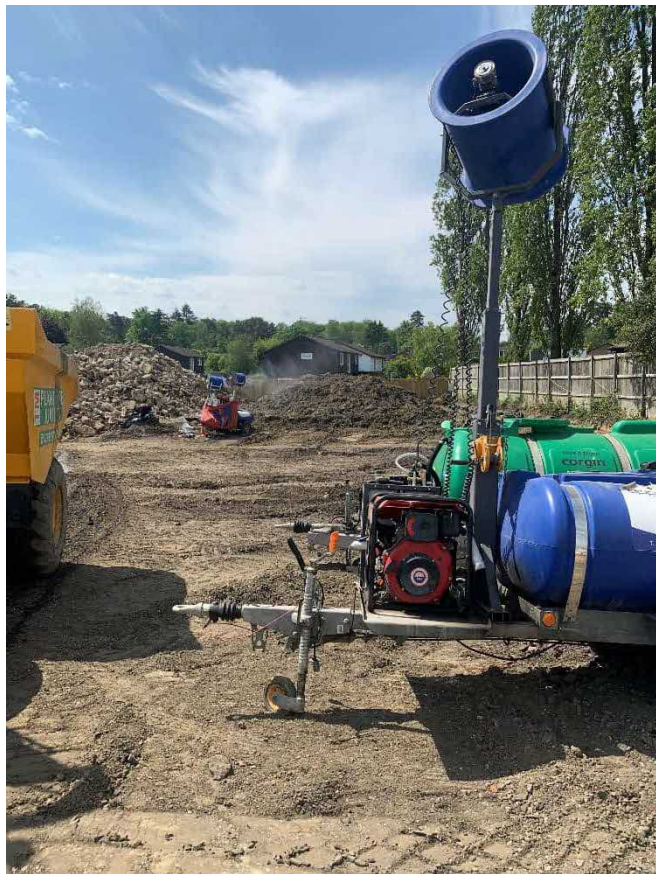
Static dust suppression
