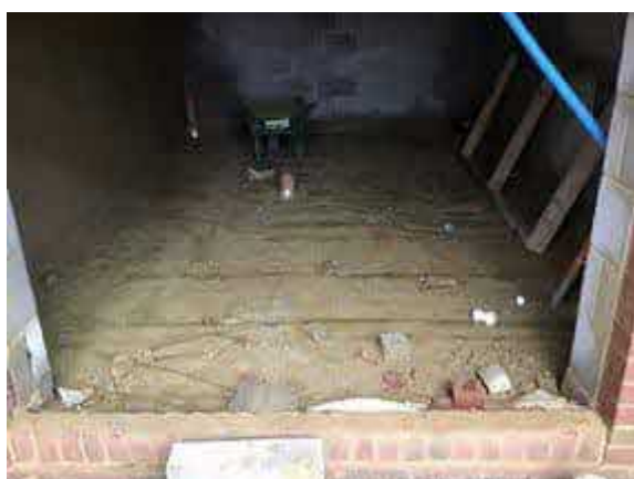
Incomplete bin store.
