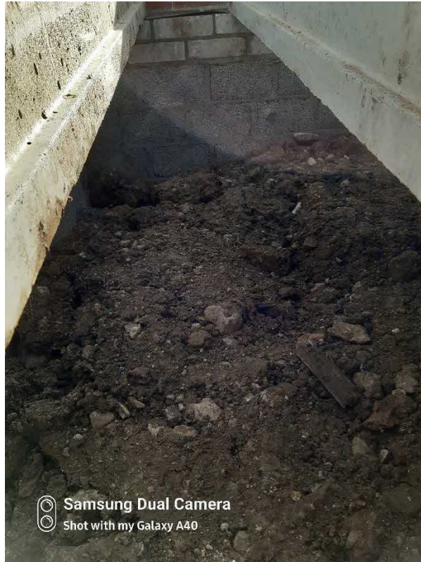
01 C8585E 19.01.22 Plot 51 Void Space (client photo)
