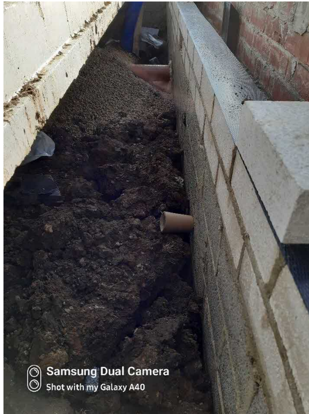
01 C8585E 19.01.22 Plot 48 Void Space (client photo)
