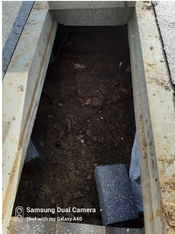
01 C8585E 19.01.22 Plot 49 Void Space (client photo)
