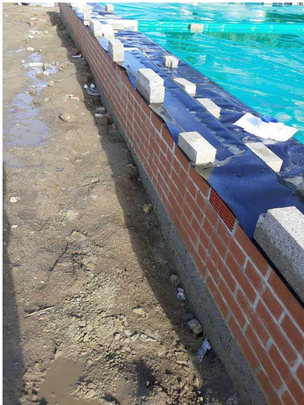
05 C8585E 29.09.22 Plot 48 Void Space Vents
