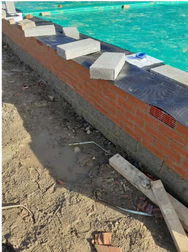
05 C8585E 29.09.22 Plot 51 Void Space vents
