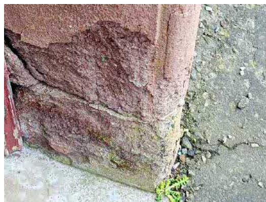
14. Salt damaged door jamb
